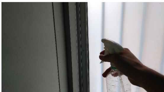
体育館トイレの窓のふち
