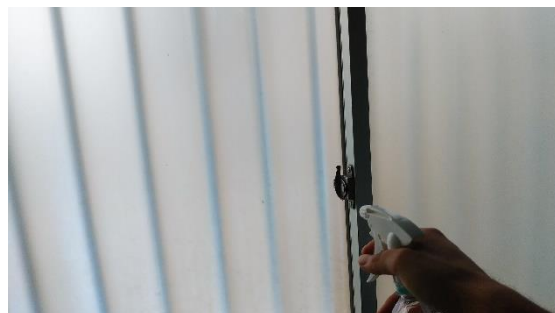
体育館トイレの窓の鍵
